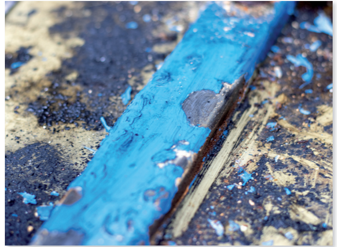
Afbeelding 3: aangetast staal binnenkant LBK
